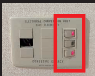
メイクルーム内 電灯スイッチ エアコンスイッチ
