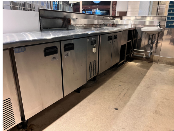
種別：冷蔵冷凍庫 個数：2 詳細：冷蔵扉×3 / 冷凍扉×1
