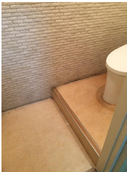
トイレの入口幅が60cm、段差は8cmと15cmです 手すりはございません。
